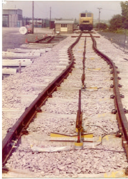
FIG. 7.3: Flambage de rails
