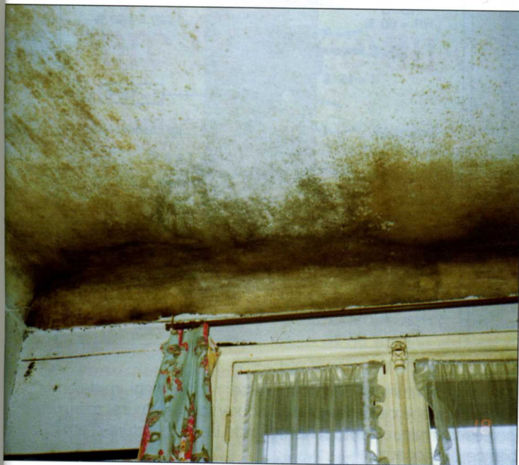
Les condensations touchent les parois les plus froides du logement.
