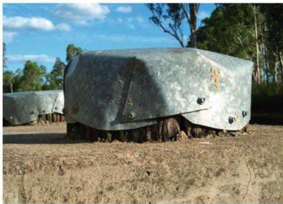
Protection sur tête de pieu d'ouvrage d'irrigation australien (Silveleaf weir) Source : Office National des Forêts / Damien Roman / janvier 2009
